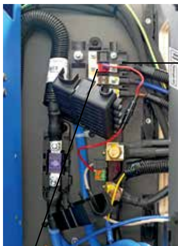
Säkringsblock, huvudsäkringar B2
