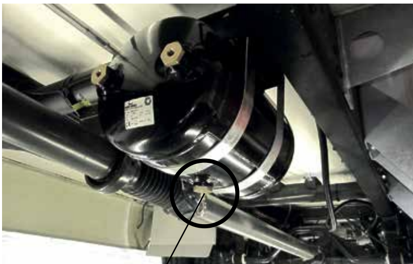
Avtappningsskruv för kondensvatten i trycklufttanken
