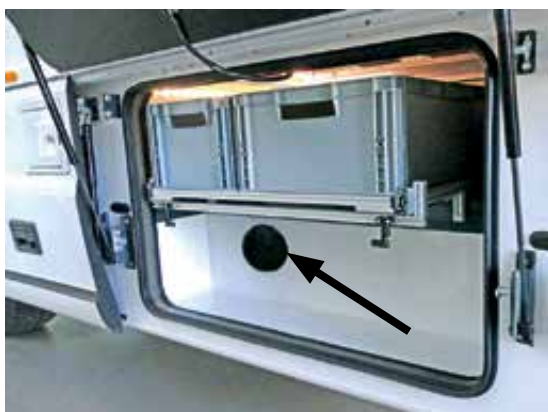
Inspektionsöppning första upphängning 190 l dieseltank i undergolvfack, förarsidan
