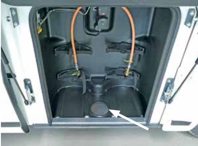
Gasolflaskutrymme bakom undergolv- lucka till gasolflaskut- rymmet
