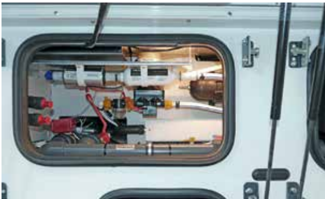
Anslutningsfack vatteninstallation bakom undergolv- lucka, förarsidan
