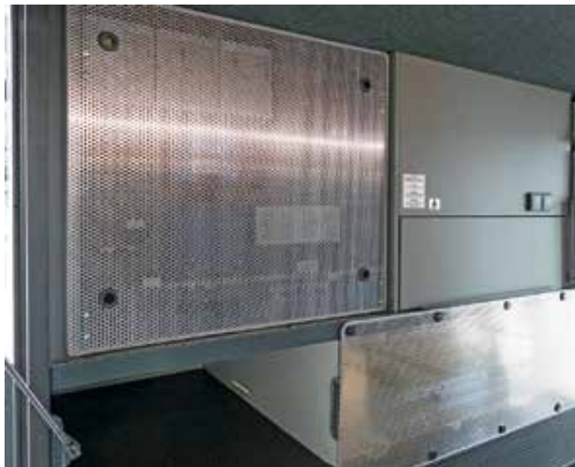
Central elsystem bodel, skyddat bakom perforerad plåt
