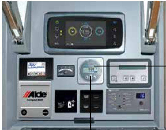
Manöverpanel batterivakt (BMV-712 Smart) vid ingången
