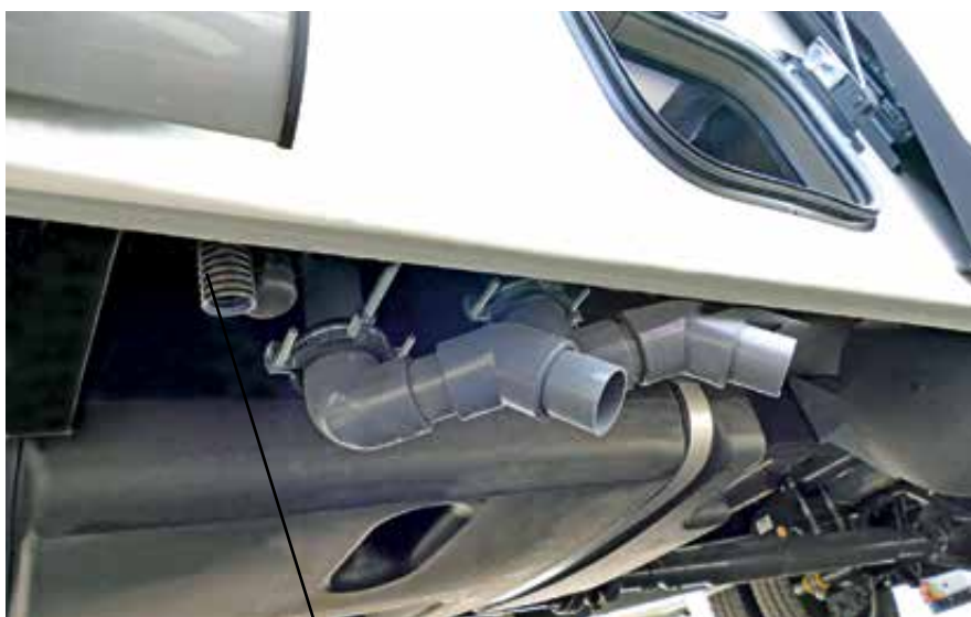
Avledning spillrör expansionskärl, bakslagsventil värmepanna och tryckavlastningsventil värmepanna
