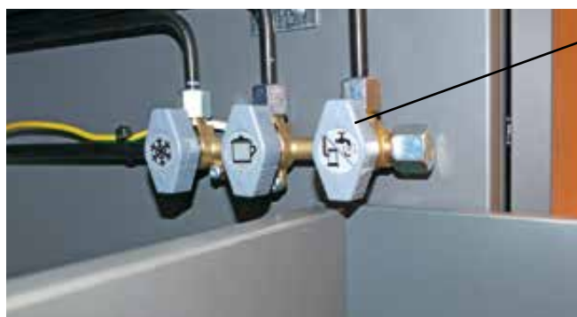
Gasventil värme-panna = öppen
