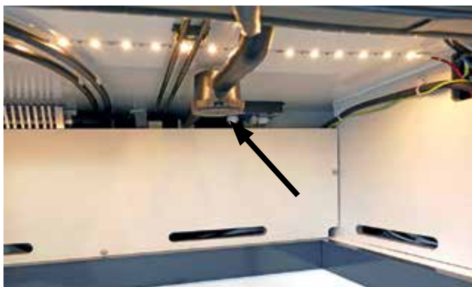
Vattenlåsbeslag tvättställ bakom dubbelgolv- lucka på passage- rarsidan
