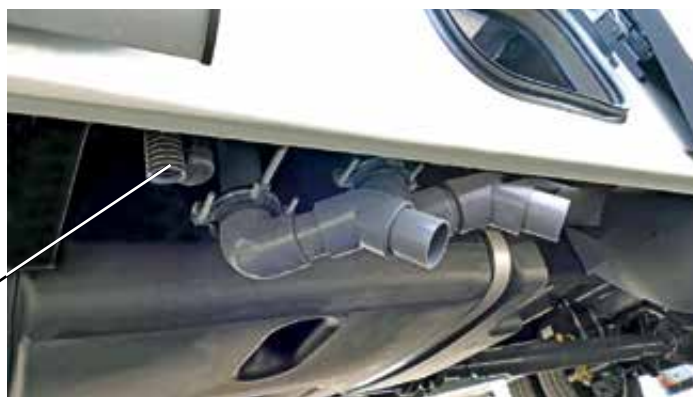
Slangstuts från VVB, bakslags- och tryckavlastningsventil tillsammans i ett rör som leds ut under fordonet
