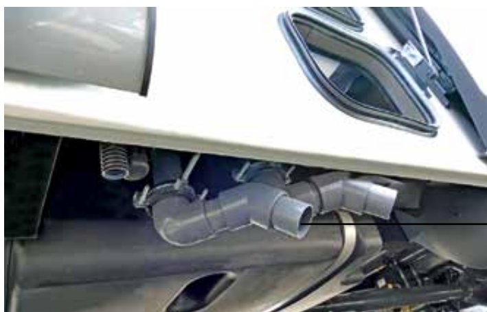
Gemensamt utloppsrör för avlopps- och latrintank
