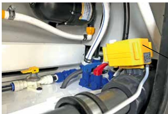
Ulostesäiliön sähköinen tyhjen- nysventtiili
