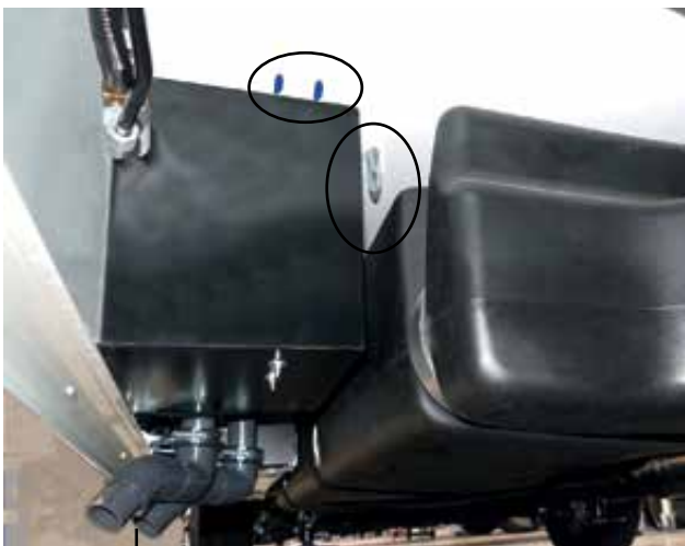
Poisto- ja tyhjennys-putket auton alla, huoltotilan lähellä
