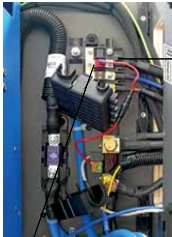
Sulakeblokki, pääsulakkeet B2
