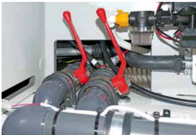
Tyhjennysventtiilit Raikasvesi- ja jätevesisäiliön tyhjennys. Venttiilit huoltotilassa (kuvassa venttiilit kiinni)
