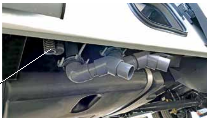
Putki boilerista, takaisku- ja ylipaineventtiili yhdistetty samaan putkeen ja johdettu auton alle
