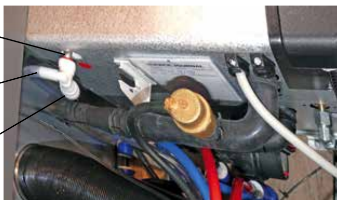
Automaattinen takaiskuventtiili, ve- sikeskuslämmitys
