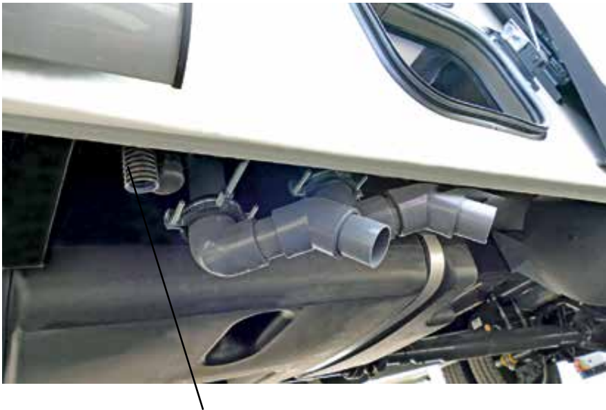
Poistoputki tasaussäiliön ylivuoto, lämmityskattilan takaiskuventtiili ja lämmityskattilan ylipaineventtiili
