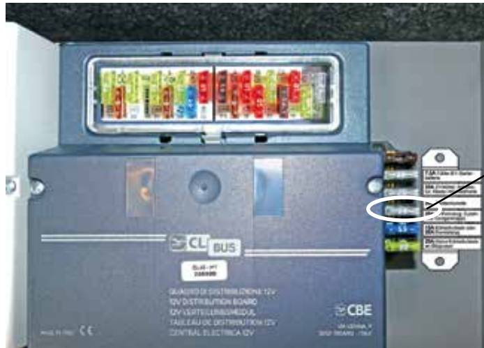
Pääsulake 25 A lattasulake
