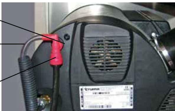
Bild över värmepanna i soffbänken, förarsidan
