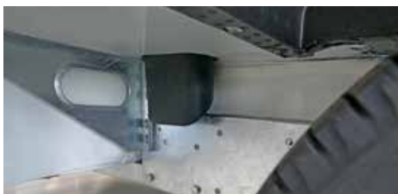
Tvångsventilation garage under garagegolvet, på passagerarsidan
