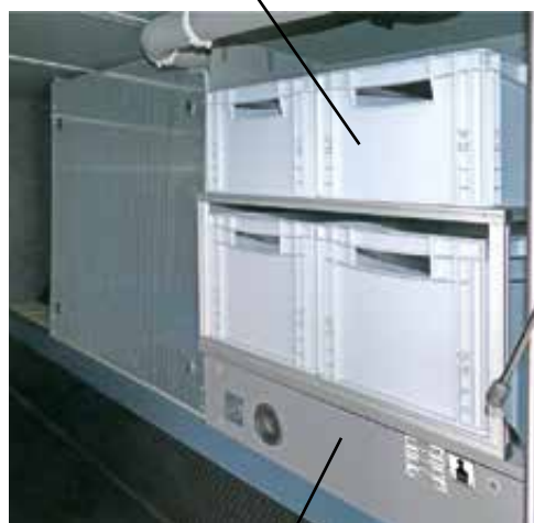
Täckskiva, inspektionsöppning, rördragning luftburen värme samt komponenter för gas- och vatteninstallation
