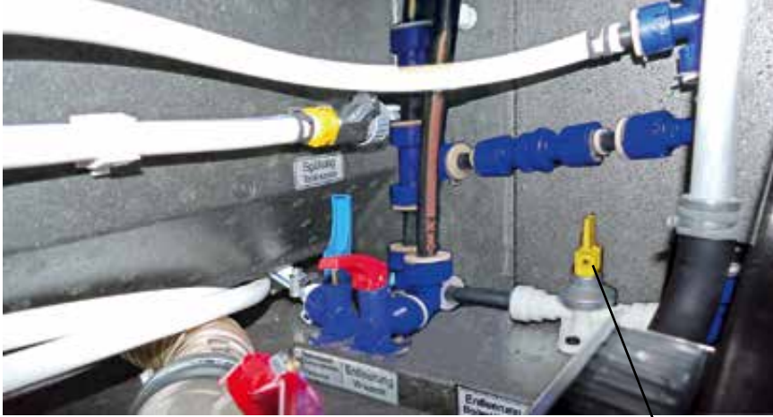
Säkerhets-/tryckavlastningsventil i anslutningsfack, förarsidan
