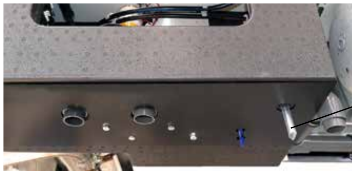
Slangstuts, säkerhets-/ avtappingsventil
