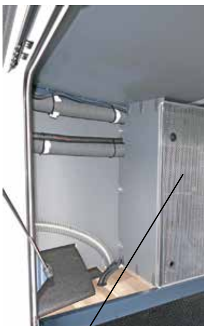
Bodelens centrala elsystem, bakom perforerad plåt
