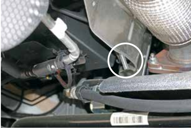
Ventilationsslang, fordonsbatteri under fordonsbatteriet
