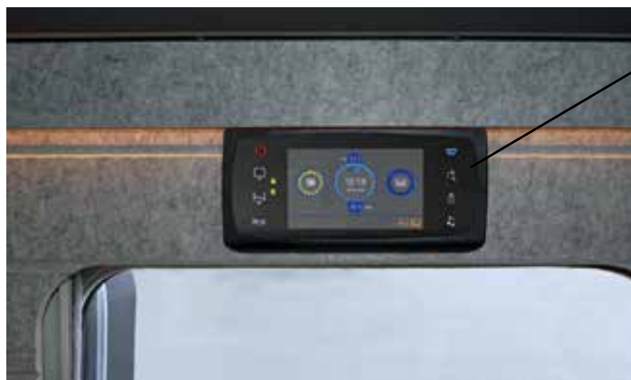
Centralpanel vid ingången
