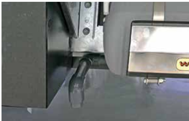
Tömningsrör, latrintank (extrautrustning) bredvid anslutningstacket
