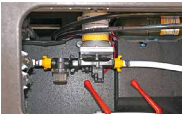
Vattenpump med vattenfilter och tryckexpansionstank i anslutningsfacket
