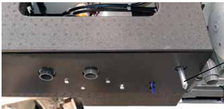
Slangstuts, säkerhets-/ avtappingsventil
