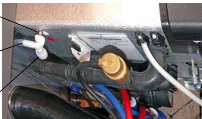
Bild över värmepanna i soffbänken, förarsidan
